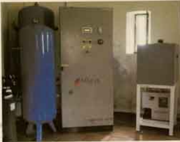
Pompa di azoto
